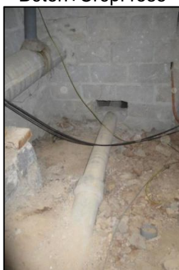
Photo N° 250 AMIANTE CIMENT - 5 rue Curie-Vide Sanitaire_5 rue Curie Conduits de fluide Chute E.U.(Fibres-ciment)
