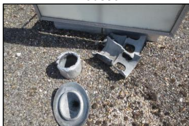
Photo N° 220 ECH-13 AMIANTE CIMENT -3 rue Curie-Toiture_3 rue Curie Conduits de fluide Chapeau+conduit de ventilation haute de la GT Gaz (Fibres- ciment)
