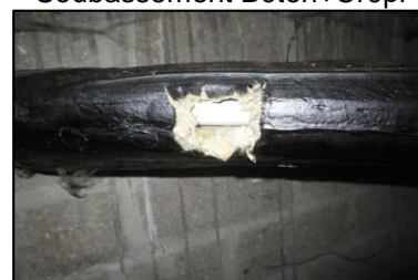
Photo N° 213 ECH-9 CALORIFUGEAGE -1 rue Curie- Vide Sanitaire_1 rue Curie Gains & coffres horizontaux Laine minérale + enveloppe bituminée
