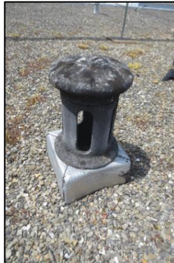
Photo N° 281 ECH-40 AMIANTE CIMENT -3 rue Calmette-Toiture_3 rue Calmette Conduits de fluide Chapeau+conduit de ventilation haute de la GT Gaz (Fibres-ciment)
