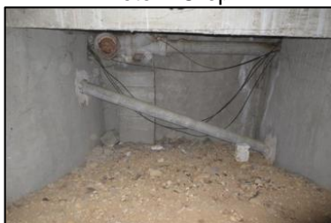
Photo N° 291 AMIANTE CIMENT - 1 rue Calmette-Vide Sanitaire_1 rue Calmette Conduits de fluide Chute E.U.(Fibres-ciment)
