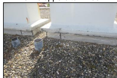
Photo N° 318 ECH-49 -5 rue Calmette-Toiture_5 rue Calmette Souches Cheminée Etanchéité type "paxalu"
