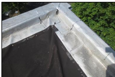
Photo N° 239 ECH-19 -5 rue Curie-Toiture_5 rue Curie Bardeaux Etanchéité type "paxalu"
