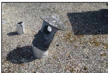
Photo N° 221 ECH-13 AMIANTE CIMENT -3 rue Curie-Toiture_3 rue Curie Conduits de fluide Chapeau+conduit de ventilation haute de la GT Gaz (Fibres- ciment)
