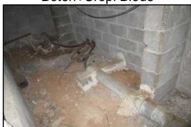
Photo N° 211 AMIANTE CIMENT - 1 rue Curie-Vide Sanitaire_1 rue Curie Fourreau de cable Conduit (Fibres-ciment)
