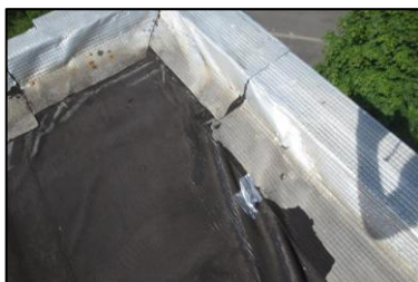
Photo N° 218 ECH-11 -3 rue Curie-Toiture_3 rue Curie Bardeaux Etanchéité type "paxalu"
