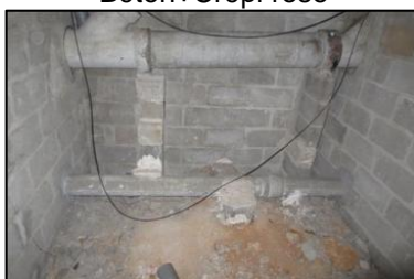
Photo N° 212 AMIANTE CIMENT - 1 rue Curie-Vide Sanitaire_1 rue Curie Conduits de fluide Chute E.U.(Fibres-ciment)
