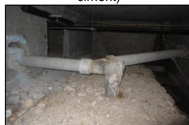
Photo N° 341 ECH-46 AMIANTE CIMENT -7 rue Calmette-Vide Sanitaire_7 rue Calmette Conduits de fluide Chute E.U.(Fibres-ciment)
