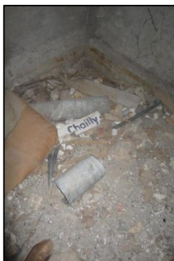
Photo N° 304 ECH-46 AMIANTE CIMENT -5 rue Calmette-Vide Sanitaire_5 rue Calmette Débris de Conduit (Fibres-ciment)
