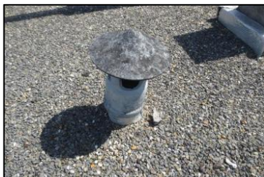
Photo N° 243 ECH-21 AMIANTE CIMENT -5 rue Curie-Toiture_5 rue Curie Conduits de fluide Chapeau+conduit de ventilation haute de la GT Gaz (Fibres-ciment)
