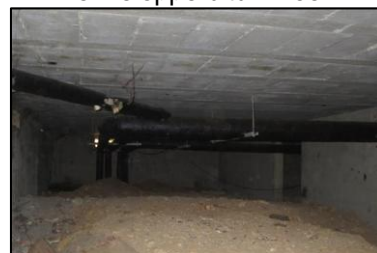
Calmette-Vide Sanitaire_5 rue Calmette Gains & coffres horizontaux Laine minérale + enveloppe bituminée
