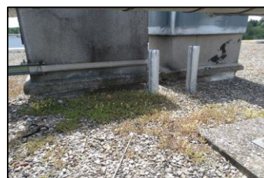
Photo N° 259 ECH-29 -1 rue Calmette-Toiture_1 rue Calmette Souches Cheminée Etanchéité type "paxalu"
