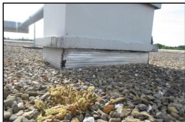
Photo N° 331 ECH-59 -7 rue Calmette-Toiture_7 rue Calmette Souches Cheminée Etanchéité type "paxalu"
