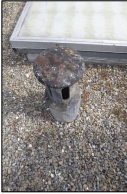
Photo N° 355 ECH-69 AMIANTE CIMENT -9 rue Calmette-Toiture_9 rue Calmette Conduits de fluide Chapeau+conduit de ventilation haute de la GT Gaz (Fibres-ciment)
