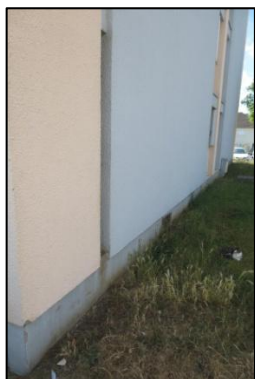
Photo N° 299 ECH-53 -5 rue Curie-Façade_5 rue Curie Murs
