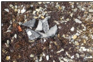
Photo N° 334 ECH-60 AMIANTE CIMENT -7 rue Calmette-Toiture_7 rue Calmette Débris (Fibres-ciment)
